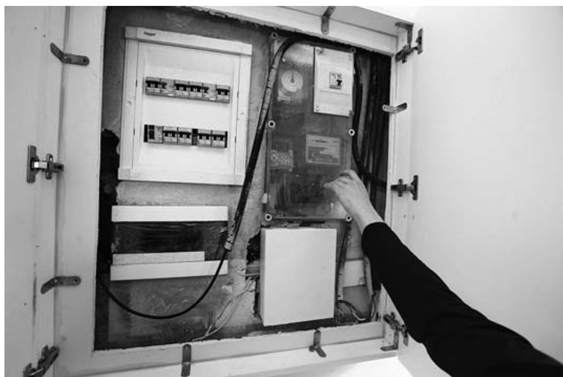
Un contador de luz en una vivienda.
