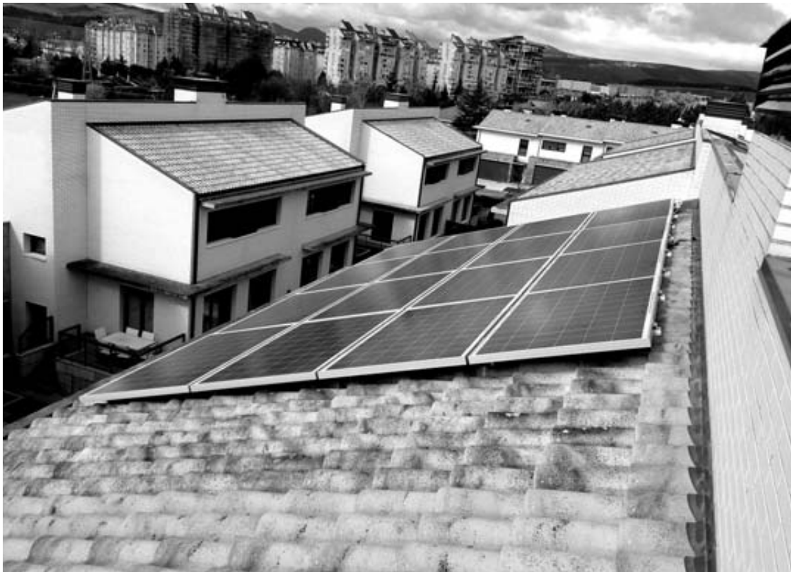
Paneles solares para autoconsumo instalados por ISF en una vivienda de Zizur.
