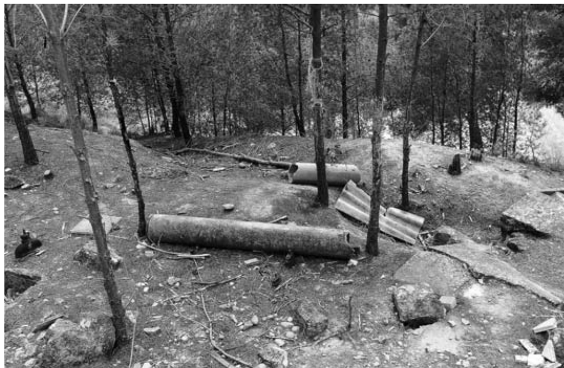
TUBERÍAS "ABANDONADAS" Izquierda-Ezkerra facilitó ayer varias fotos para denunciar la presencia de tuberías abandonadas en distintos lugares. En la imagen, cerca de los depósitos de la Virgen de la Cabeza.
