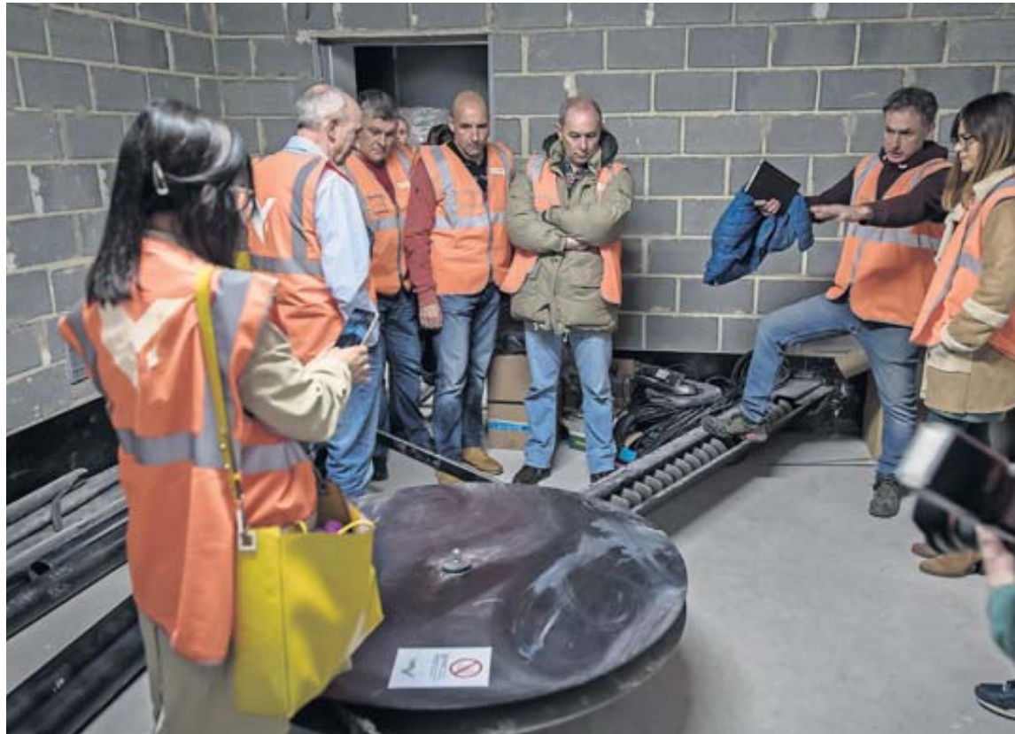
Participantes en la jornada observan el sistema de aireación del silo donde se va a conservar la biomasa con la que funcionará la caldera.
