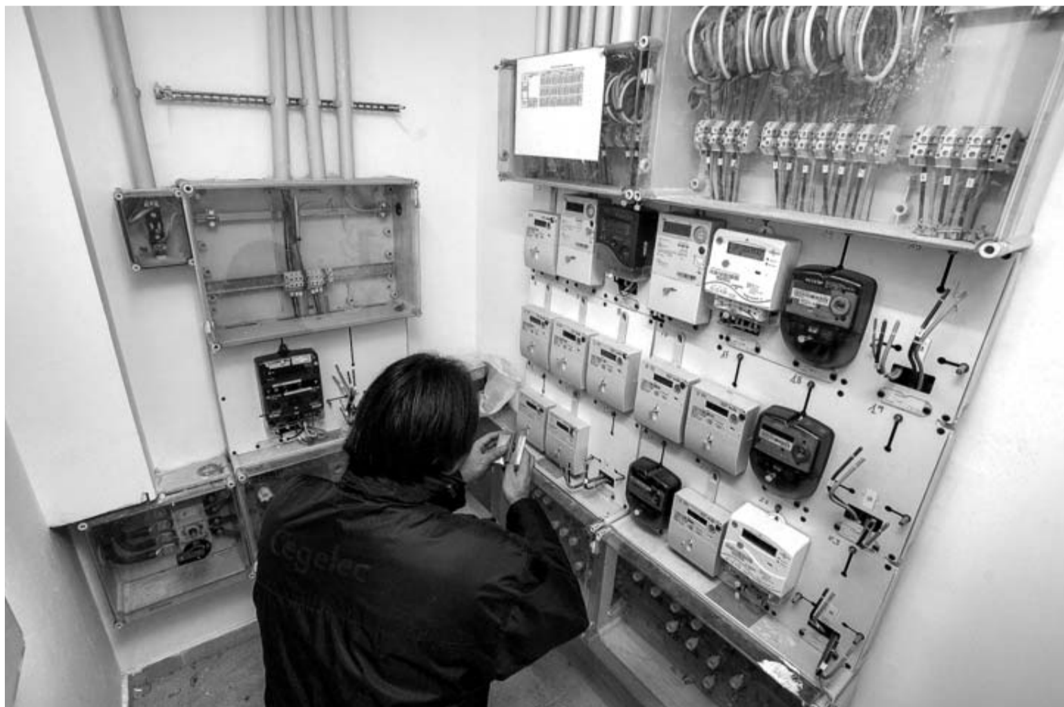
Cuadro de contadores de un edificio en Miranda de Ebro (Burgos).
