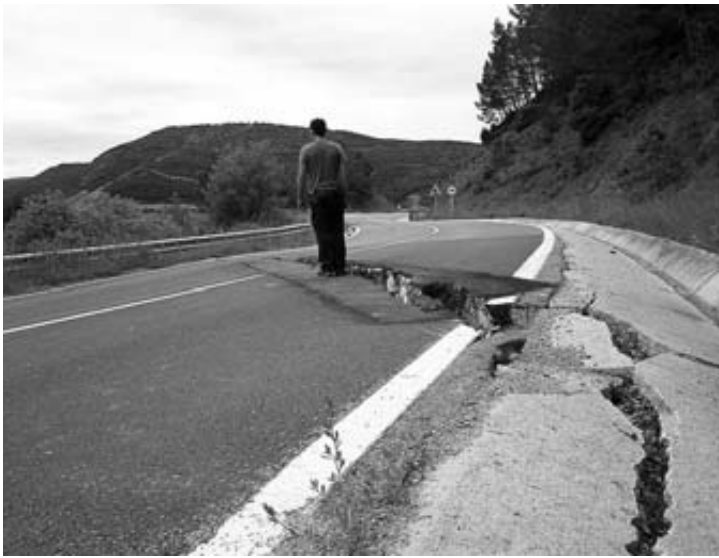
Grieta que atraviesa la antigua carretera junto al embalse de Yesa.DN
