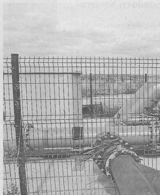
El sistema provisional de riego, ya desacoplado
