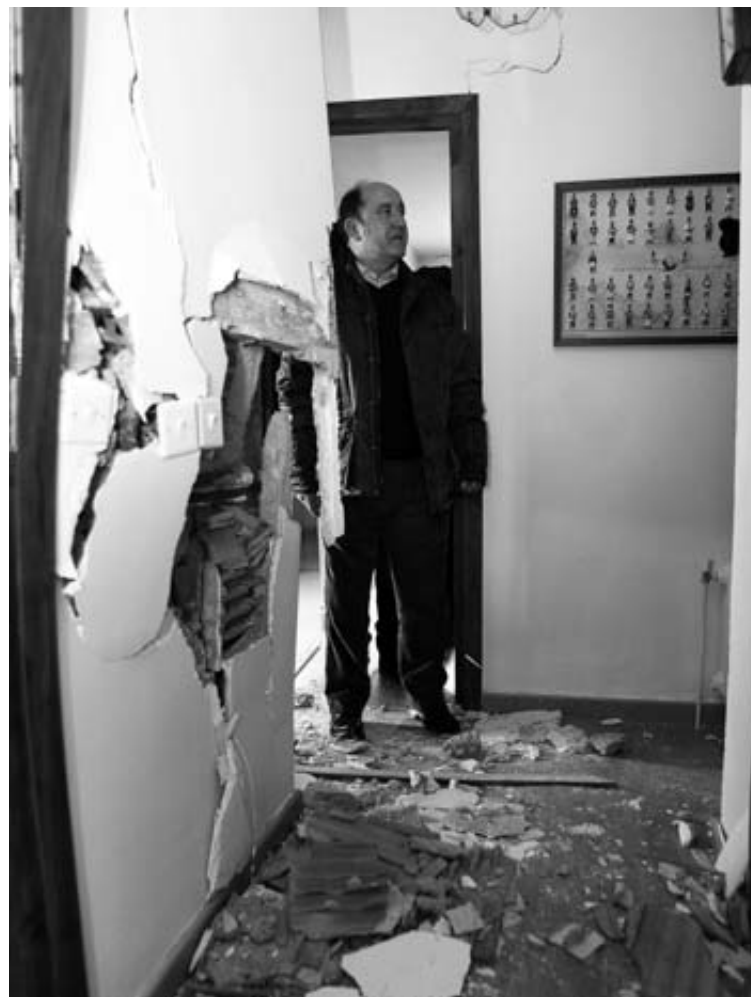
Destrozos en una de las casas de Lasaitasuna por el deslizamiento. DN
