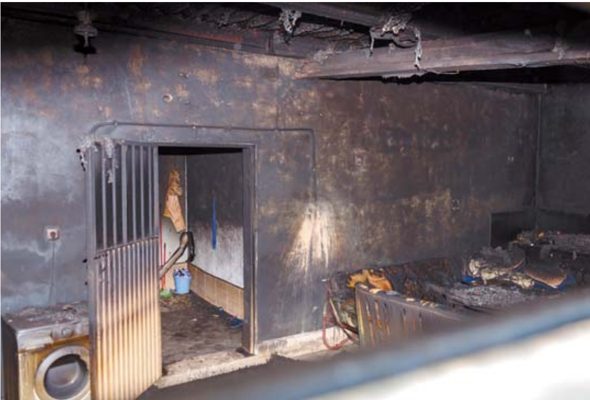
Interior de la cochera, con las paredes ennegrecidas por el humo.
