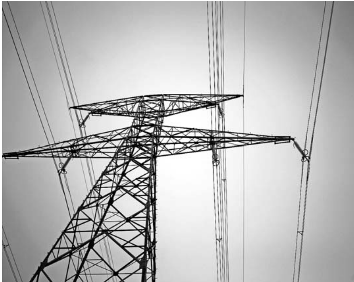
Una torre de electricidad de alta tensión.
