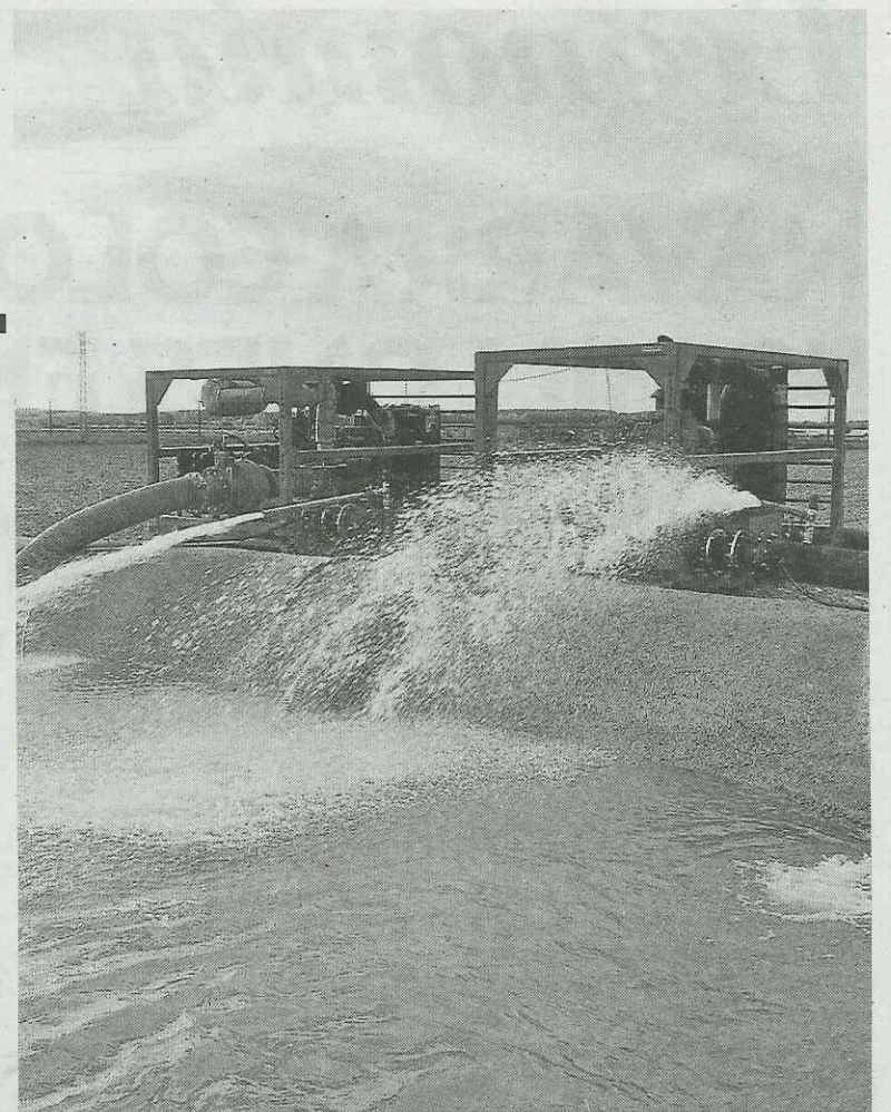
Sistema de bombeo usado el año pasado en Funes. Foto: María San Gil
