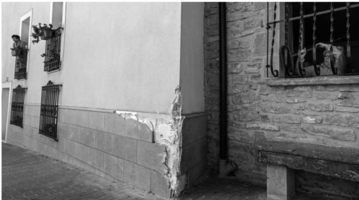
LIMPIANDO LOS DESPERFECTOS. María Teresa Fernández, propietaria de la vivienda donde chocó el coche, contempla la calle desde el balcón mientras su vecina retira con una escoba los cristales que entraron por su ventana. MONTXO A.G.
