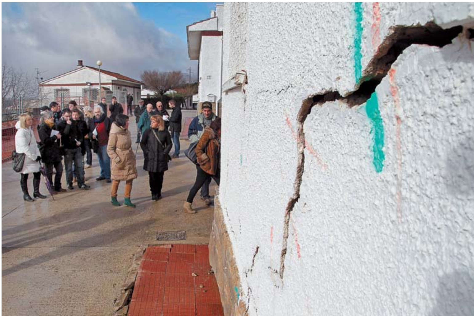
Parlamentarios y vecinos acceden a una de las casas de Lasaitasuna con graves daños estructurales.
