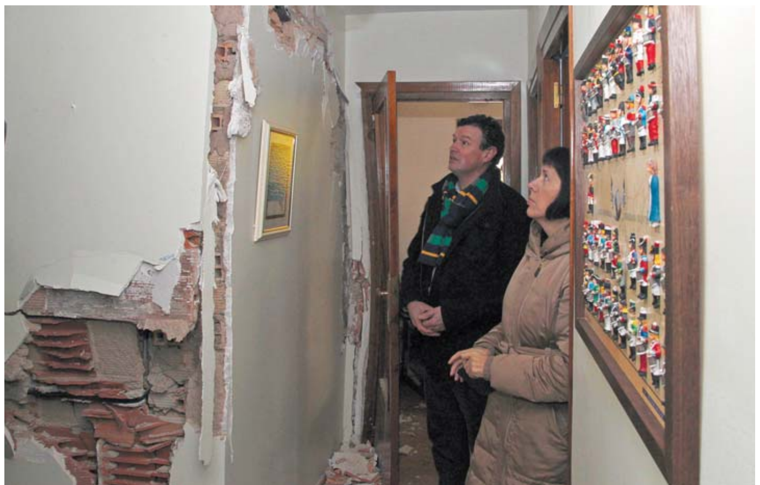
Los parlamentarios Jesús Esparza (UPN) y Maite Esporrín (PSN), en una de las viviendas con graves daños estructurales.
