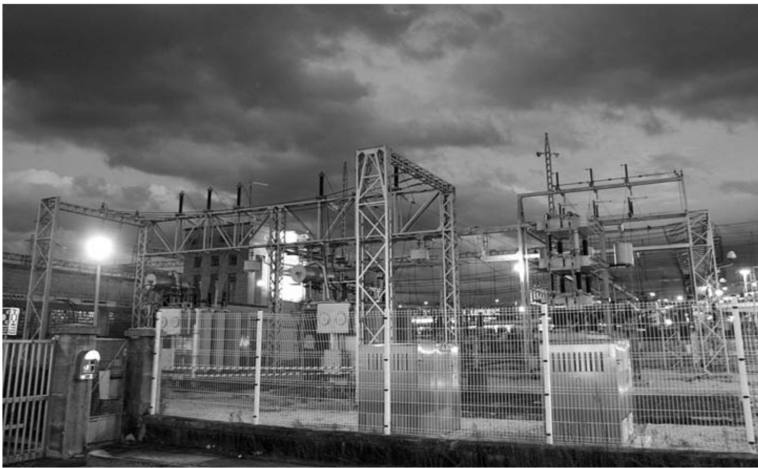
Estación eléctrica de Iberdrola en Cordovilla.
