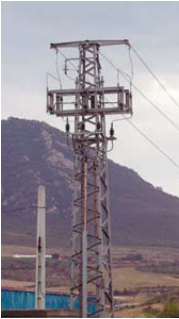
Tendido eléctrico en Estella. DN
