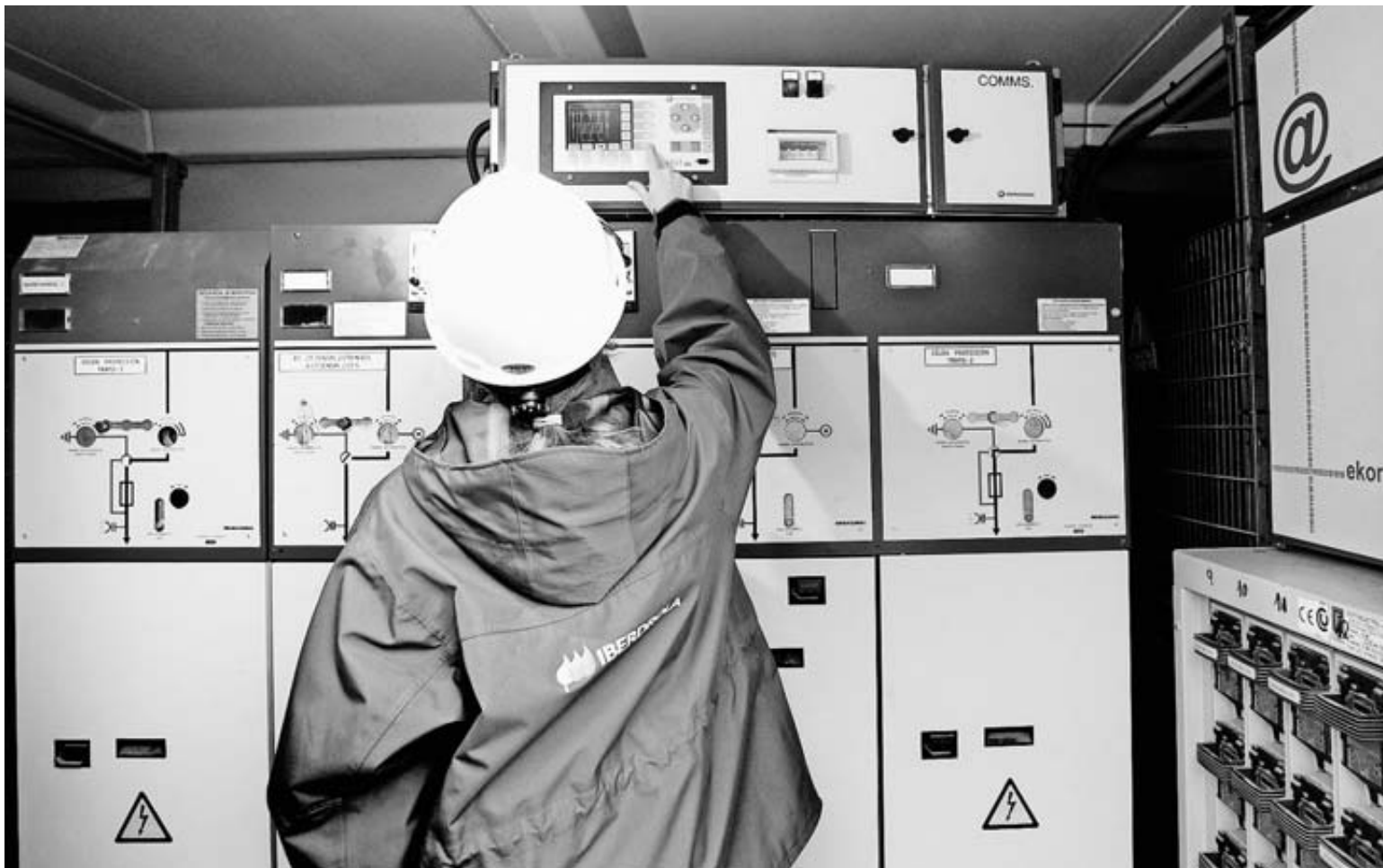
Un técnico revisa el cuadro de contadores eléctricos en una comunidad de vecinos.
