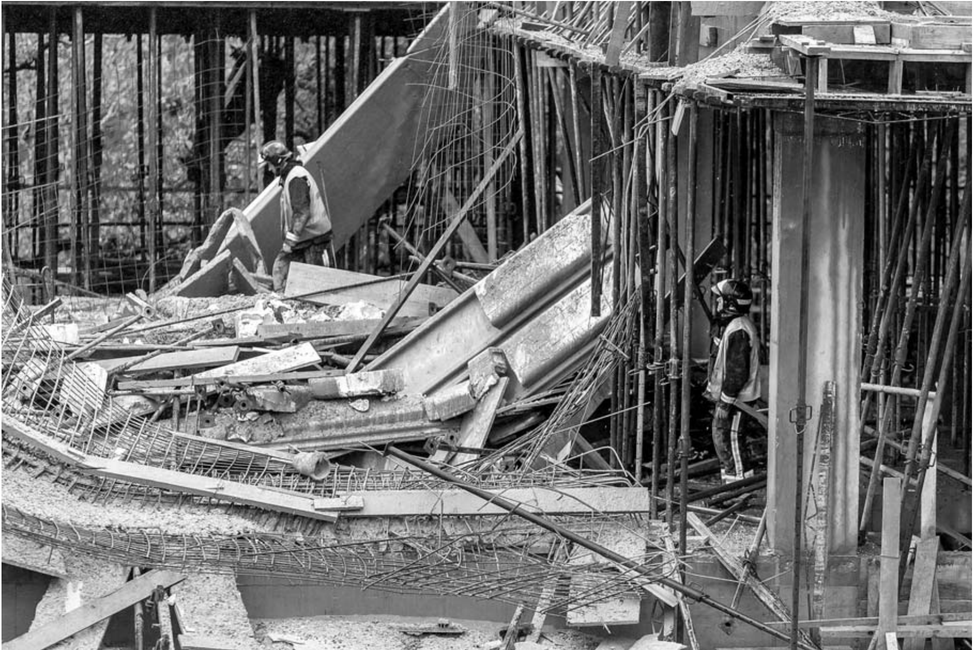
Los bomberos trabajan sobre los escombros de hormigón, mallazo, vigas y placas que se vinieron abajo y atraparon a los trabajadores.
