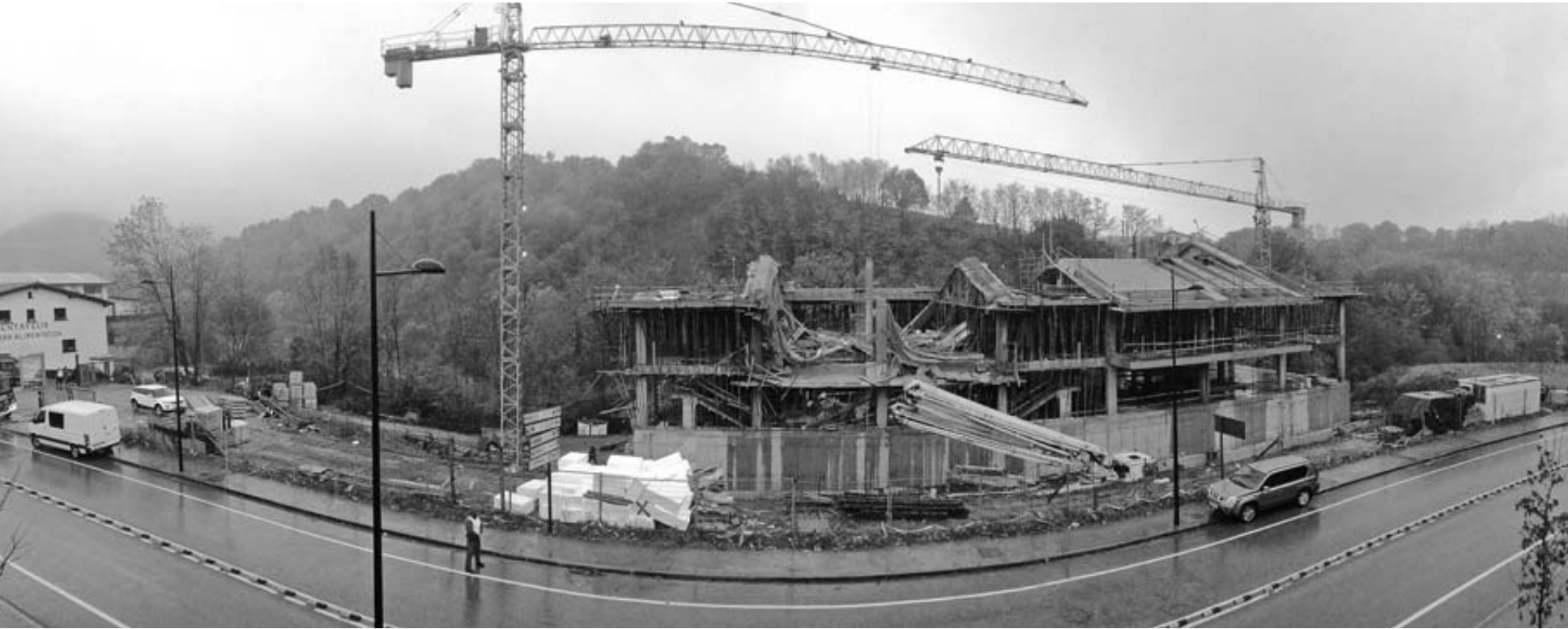
Vista general de la Venta en construcción donde se produjo el accidente, situada en la travesía de Dantxarinea. La imagen está tomada desde Venta Peio. JESÚS CASO
