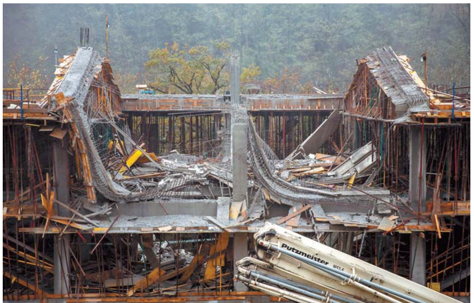
El accidente se produjo al mediodía al desplomarse la cubierta y hundir dos plantas del edificio.
