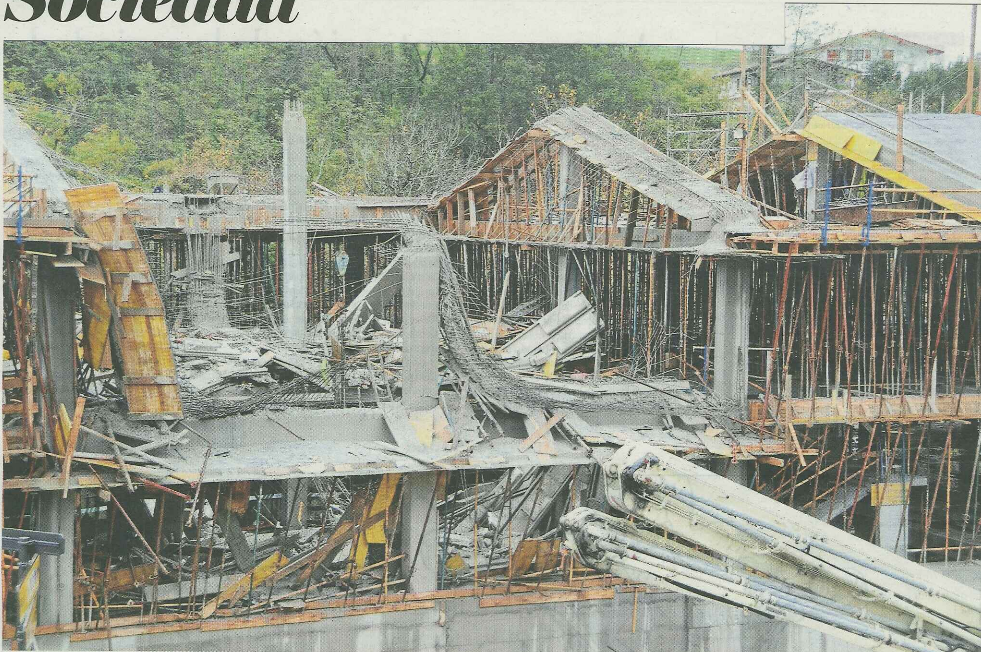
Vista general del edificio en la que se aprecia la estructura metálica de la cubierta totalmente colapsada y el material que cayó a la planta inmediatamente inferior.
