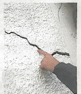
Grieta en una vivienda. Foto: Iban Aguinaga
