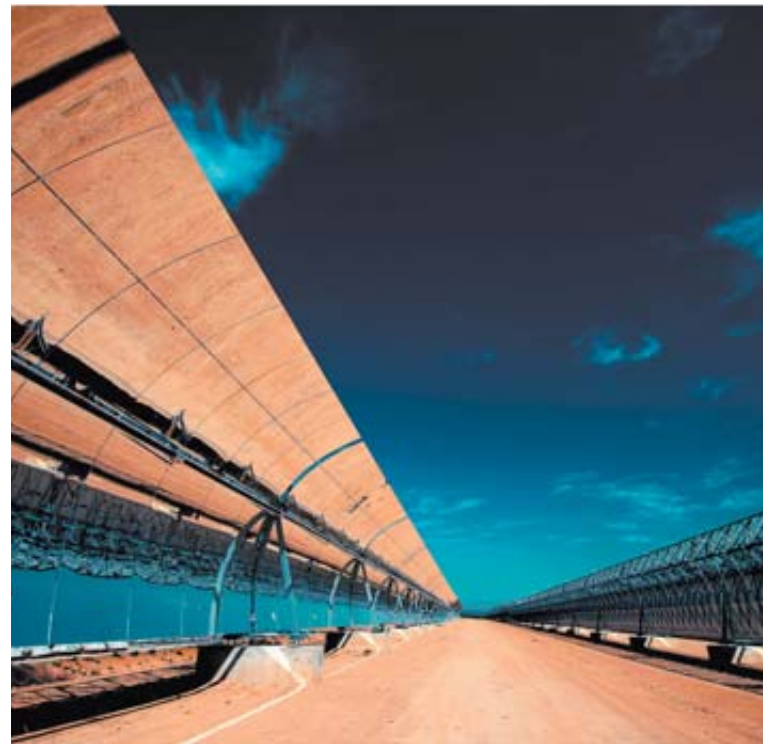
Planta termosolar de E.On en Andalucía.
