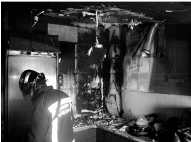
Las llamas provocaron importantes daños en la cocina de la casa. DN
