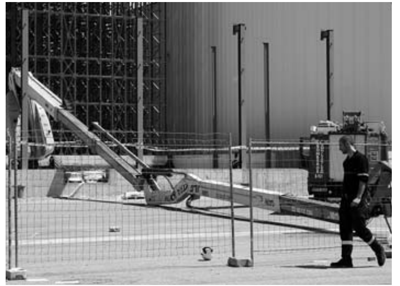
Un bombero, ante el brazo articulado de la grúa que se desplomó. GALDONA
