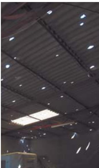
Daños en un tejado de uralita en Liédena.
